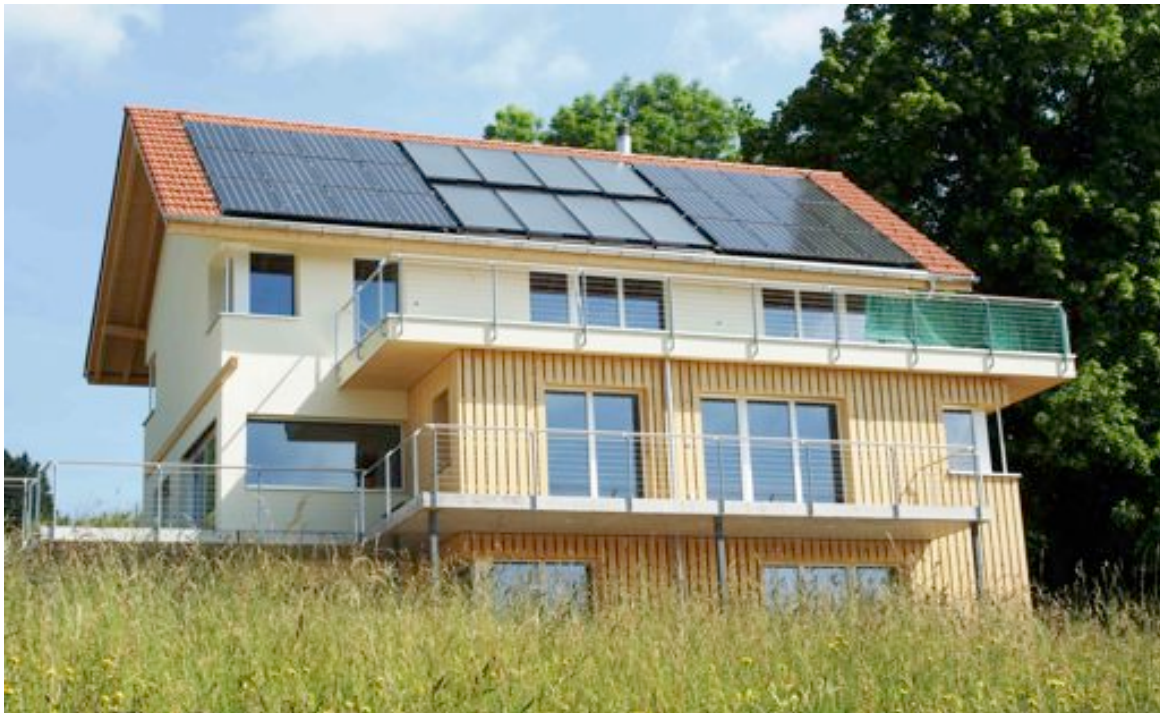
Abbildung 1: SOLAERA-Anlage kombiniert mit PV-Anlage: die 8 Hybrid-Kollektoren in der Mitte als einzige Wärmequelle nutzen Strahlung und Luftwärme
